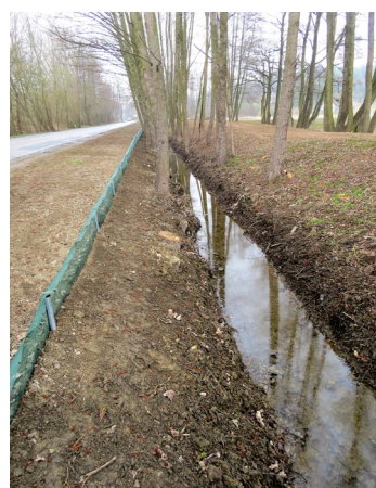
Zdjęcie 44. Wygradzenia blokujące wejście płazów na drogę
